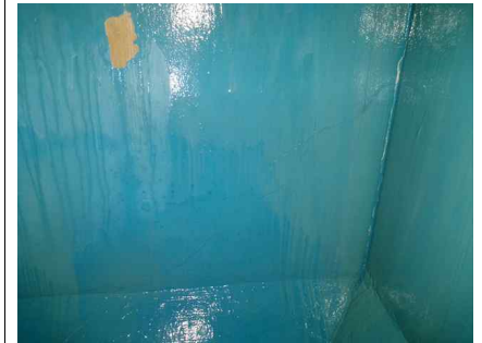
<2지 벽체 균열>
