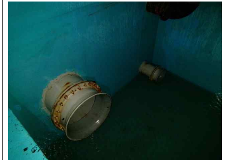
<기계설비 2지 배수지유출배관 상태양호>
