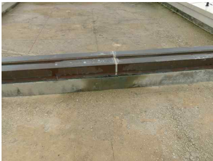
<검수실 옥상층 균열>
