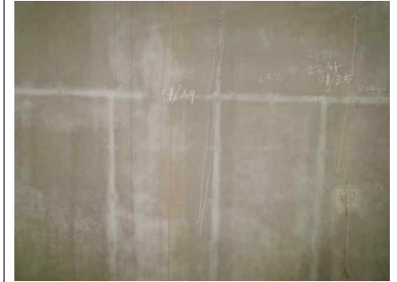
<유출밸브실 벽체 균열>
