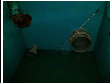
<기계설비 1지 배수지유출배관 상태양호>
