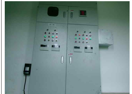
<전기설비 현장제어반 상태양호>
