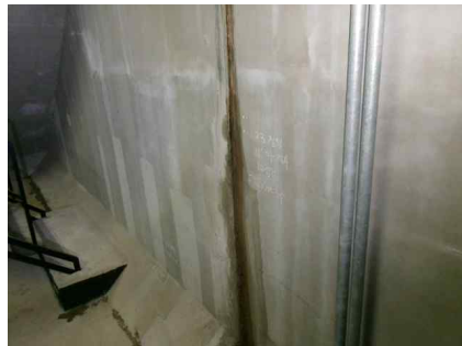
<유입밸브실 벽체 실란트 열화 및 누수>
