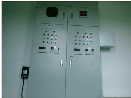
<전기실 내부 전경>
