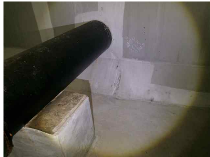
<유입밸브실 균열부 백태>
