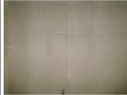
<유출밸브실 벽체 균열>
