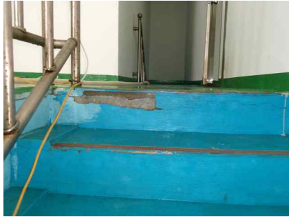
<1지 계단 파손>
