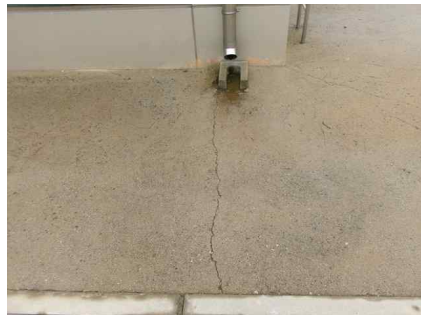
<검수실 외부바닥 균열>
