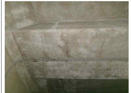
<유출밸브실상부슬래브 균열부 백태>
