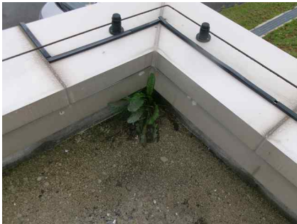
<검수실 옥상층 배수로 막힘>
