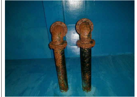
<기계설비 2지 배수지 배관 부식>
