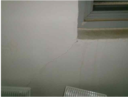
<검수실 벽체 균열>
