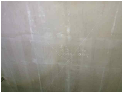
<유입밸브실 벽체 균열>
