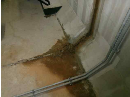
<유입밸브실 바닥슬래브 누수>
