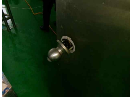
<검수실 내부도어 손잡이 파손>
