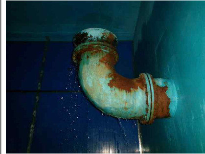
<기계설비 1지 배수지 배관 부식>
