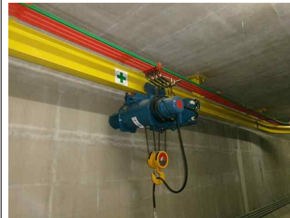
<기계설비 호이스트 상태양호>
