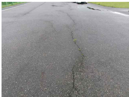
<포장부 아스콘 균열>
