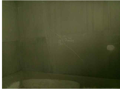
<유입밸브실 벽체 균열>
